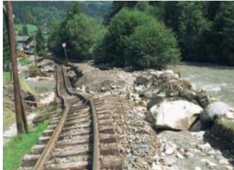
Hochwasser 1987 in Wald: Schäden an der Pinzgau-Bahn
